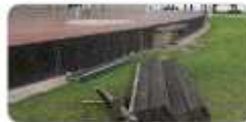
축제장 시설 파손
