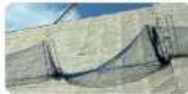
낙하물 방지망 파손
