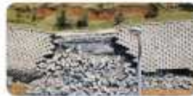
붕괴 위험(옹벽, 축대 등)
