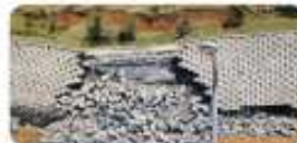
붕괴 위험(옹벽, 축대 등)
