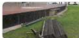
축제장 시설 파손
