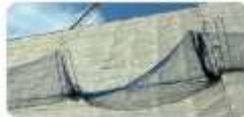
낙하물 방지망 파손
