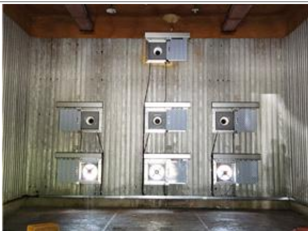
소음 저감 운전 고려한 팬 설치
