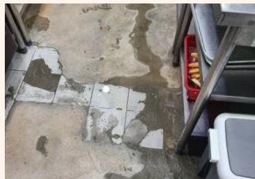
바닥 타일 균열 및 물고임
