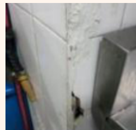
벽 파손 등 청결관리 미흡
