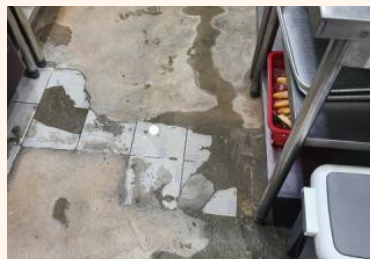
바닥 타일 균열 및 물고임
