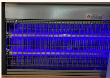
방충등 설치 미흡(충격식 포충등)
