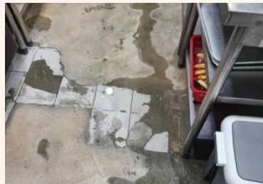
바닥 타일 균열 및 물고임
